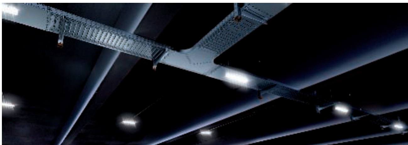
Diodový osvětlovací systém v parkovací garáži
