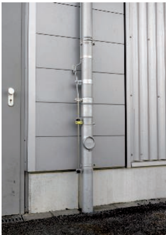
Bleskový svod na odpadní dešťové trubce
