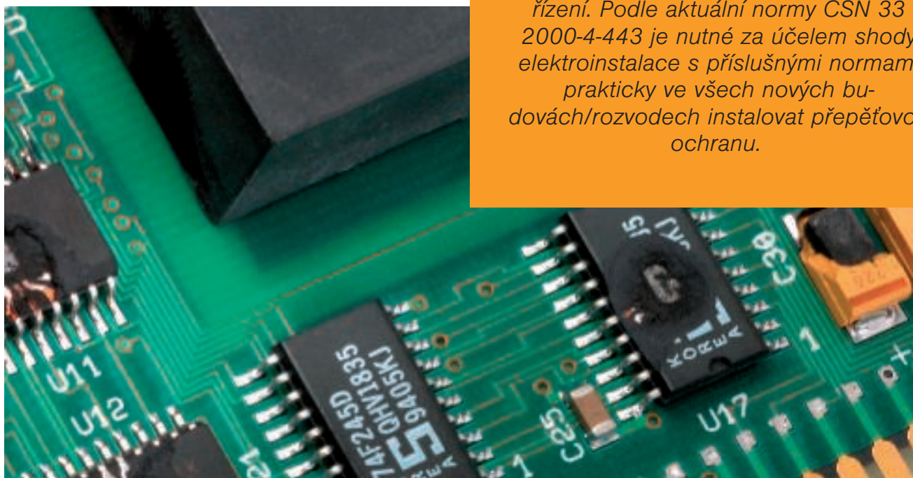
Poškození desky přepětím
