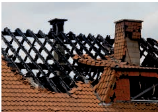
Škody na budově při přímém úderu blesku
